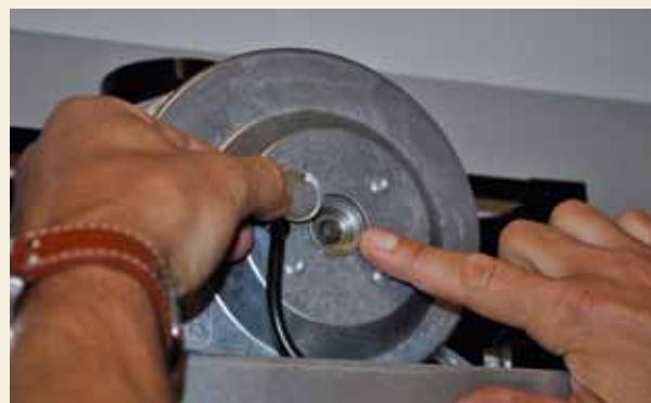
4a. Controleren of de ventilator goed werkt
