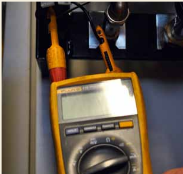
1. Meten van het thermokoppelspanningscircuit
